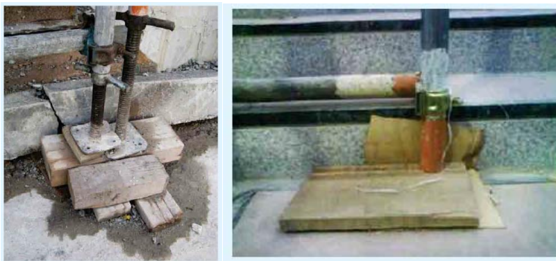
Sastatnes montētas uz nestabilas pamatnes
