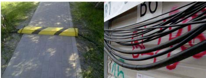
Pārvietošanās ceļos nosegti vai augstumā izvietoti kabeļi
